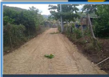
Año 2020 Mejoramiento calle por donde el Señor Edgar Ayala, colonia Bella Vista, Aldea Las Ovejas
