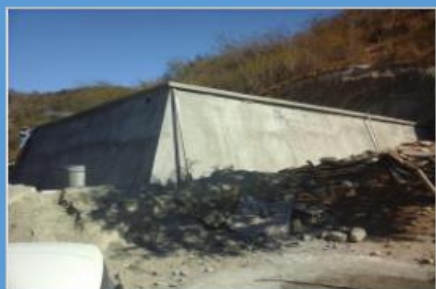
Año 2018 Ampliación Sistema de Agua Potable Tanque de Captación, Aldea Las Ovejas
