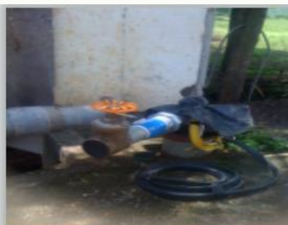
Año 2013 Mejoramiento Sistema de Agua Potable, Aldea Lo De China
