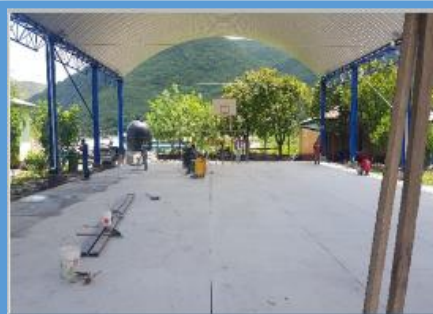
Año 2019 Mejoramiento Escuela Primaria, Aldea Agua Caliente
