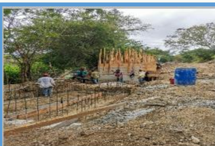
Año 2020 Construcción Planta de Tratamiento de Aguas Residuales, Aldea Los Bordos de Barillas
