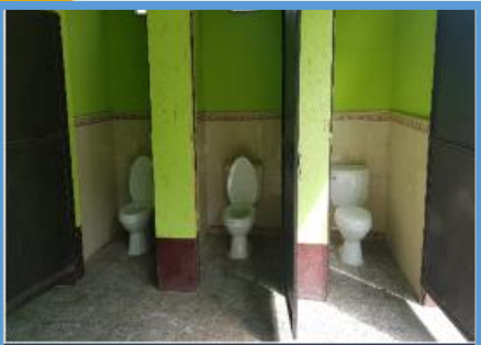
Año 2019 Mejoramiento Escuela Primaria, Aldea Agua Caliente
