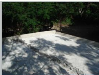
Año 2014 Mejoramiento Sistema de Agua Potable, Aldea Lo De China
